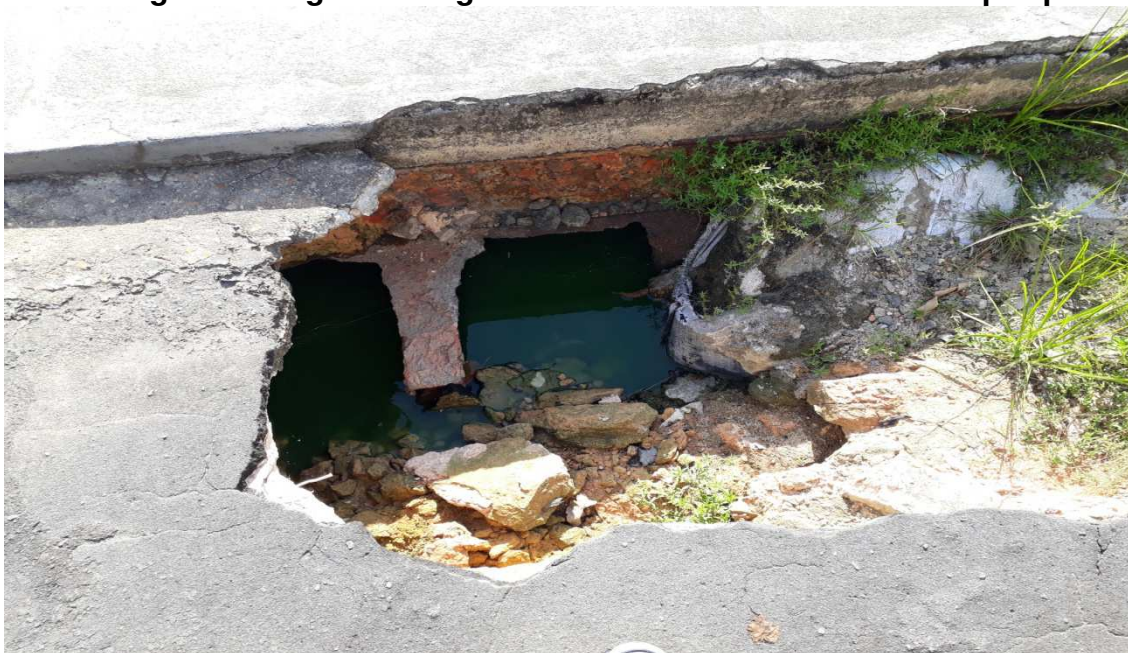
Figura 11: Água da Lagoa corroendo o infraestrutura do parque
