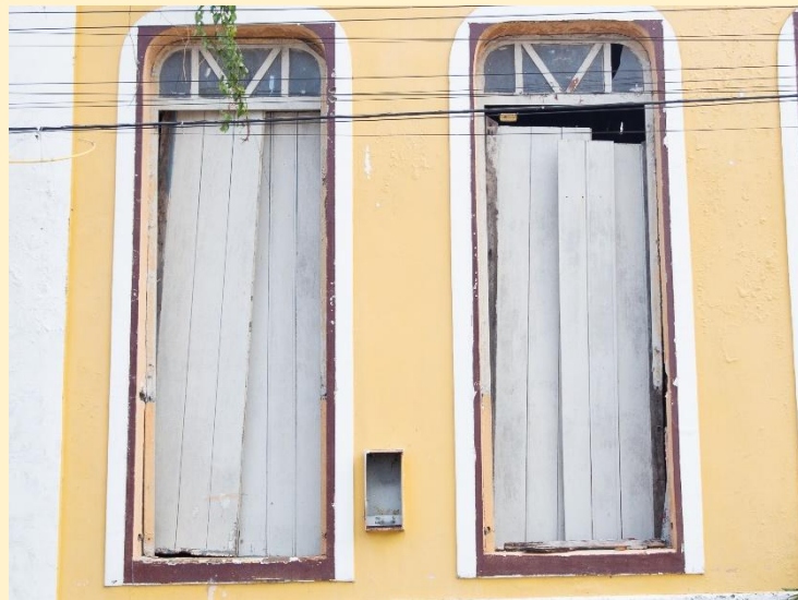
Esquadrias – janelas danificadas Fonte: Autora, 2024
