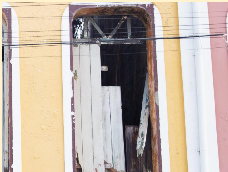
Esquadrias – porta da edificação deteriorada Fonte: Autora, 2024
