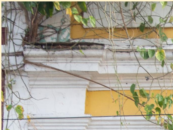
Rachadura na estrutura pela presença de vegetação Fonte: Autora, 2024
