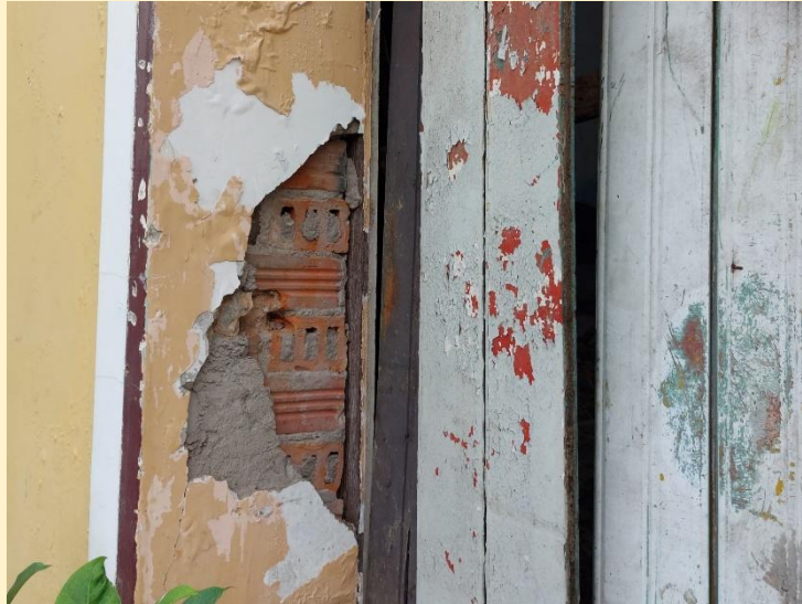
Desagregação próximo a esquadria Fonte: Autora, 2024
