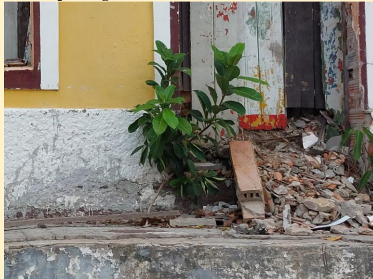
Presença de vegetação em esquadrias Fonte: Autora, 2024
