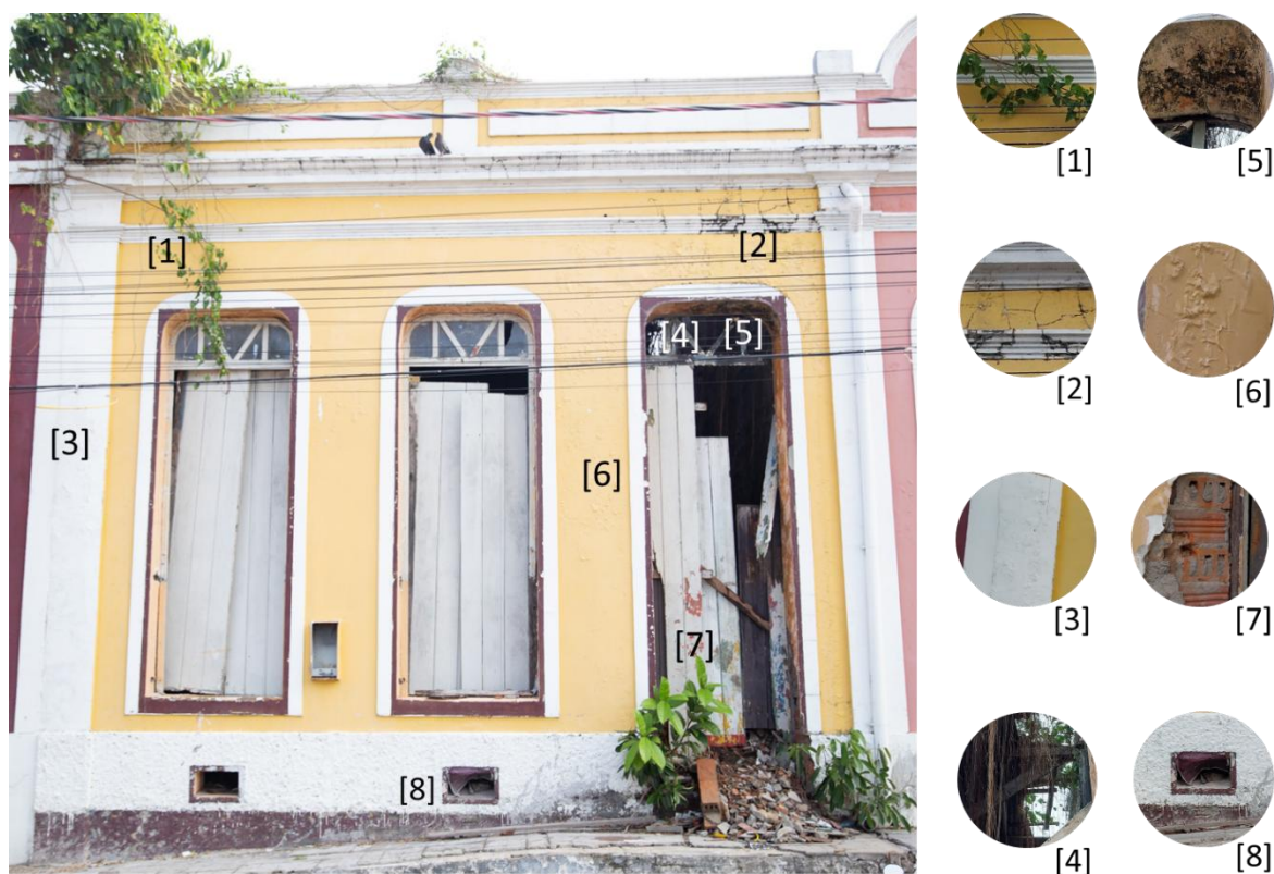
Figura 7: Mapeamento de danos
