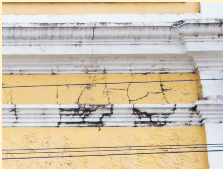
Fissuras e trincas ramificadas na parede Fonte: Autora, 2024
