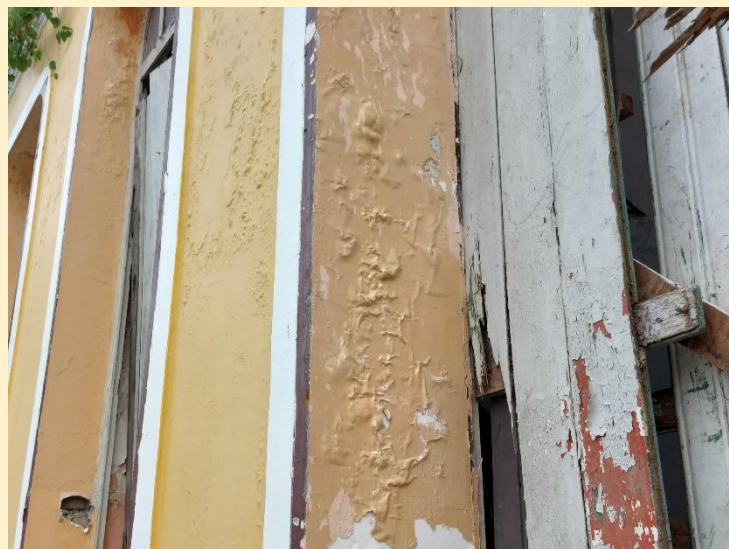
Descascamento próximo a esquadria Fonte: Autora, 2024
