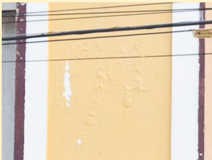
Descascamento da pintura na parede
