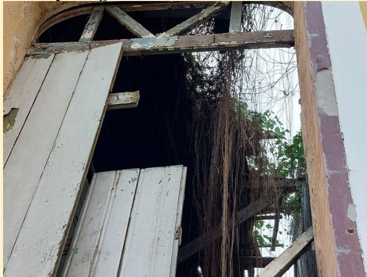
Cobertura com presença de vegetação e perda de partes
