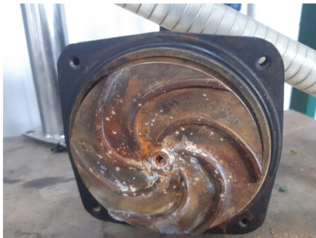
Figura 20 – Situação da Bomba Centrífuga
