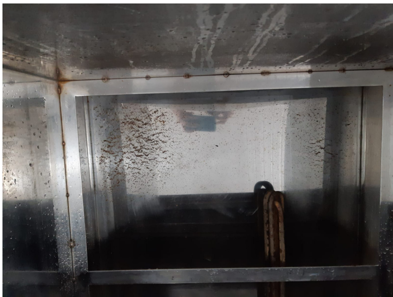
Figura 28: Incrustações Retiradas da Tubulação do Fluido Quente
