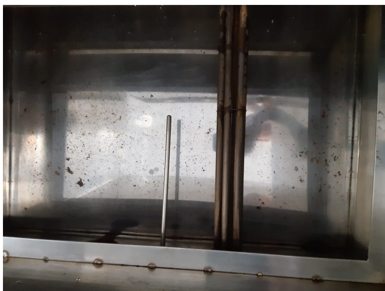
Figura 29: Incrustações Retiradas ao Final dos Experimentos da Tubulação do Fluido Quente
