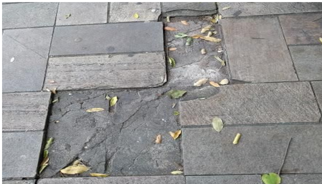
Figura 08 – Calçamento irregular na Praça da Saudade
