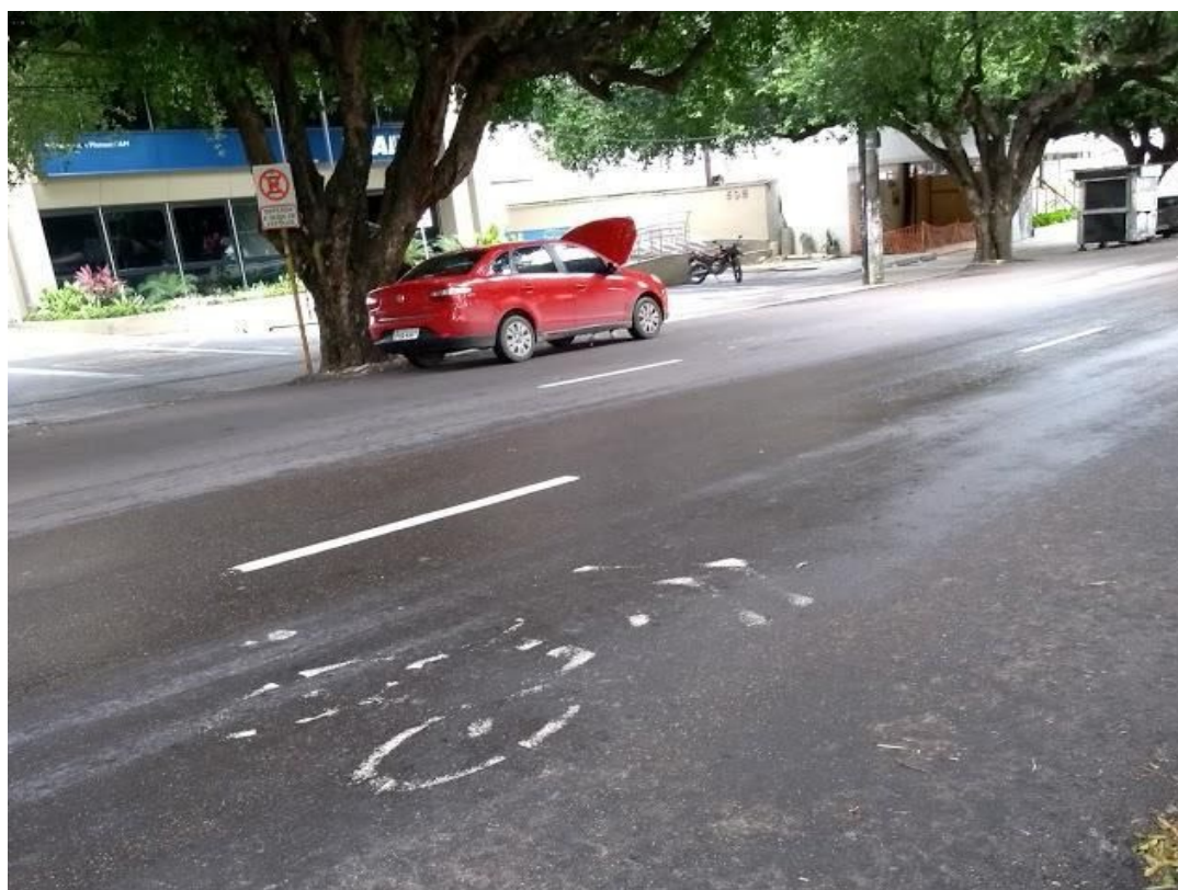
Figura 25 – Sinalização de ciclovia apagada
