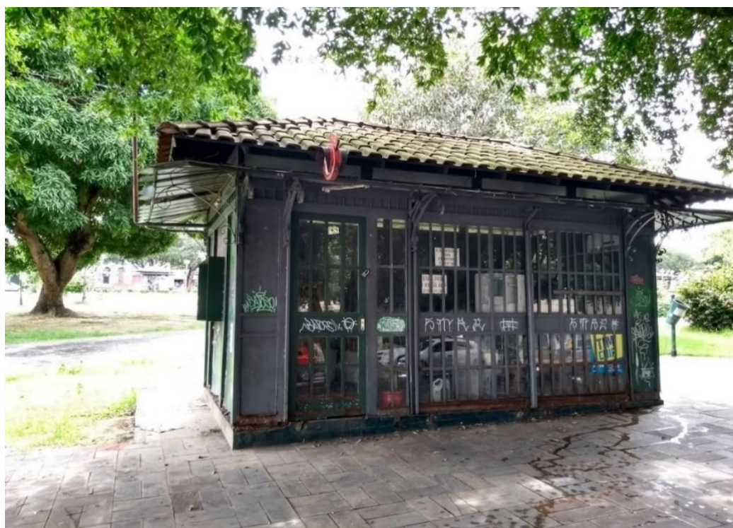
Figura 23 – Quiosque abandonado e deteriorado na rua Ramos Ferreira
