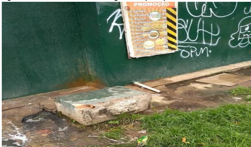
Figura 16 – Via de escoamento irregular do quiosque da Rua Simão Bolívar
