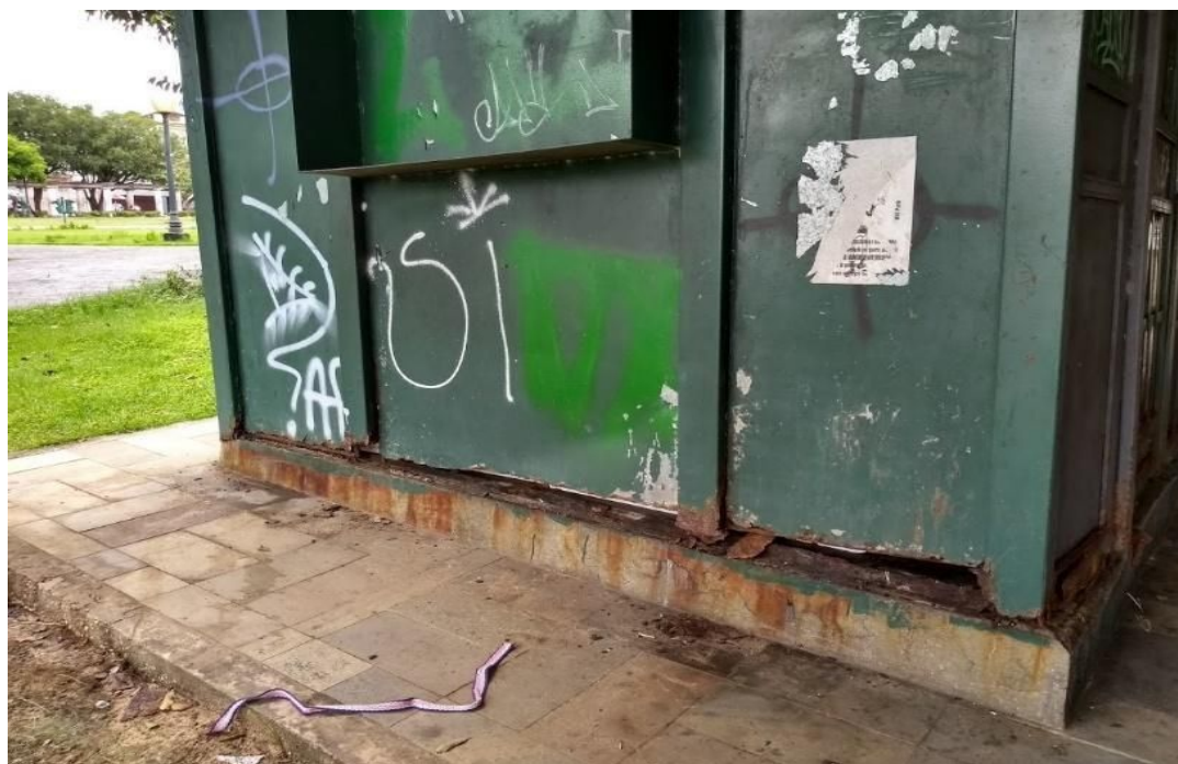
Figura 24 – Detalhe da deterioração de quiosque
