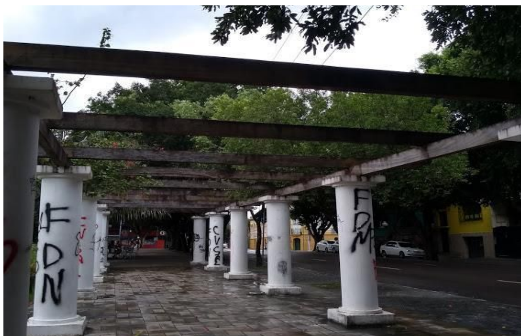
Figura 21 – Pergolado com falhas na cobertura na rua Ramos Ferreira
