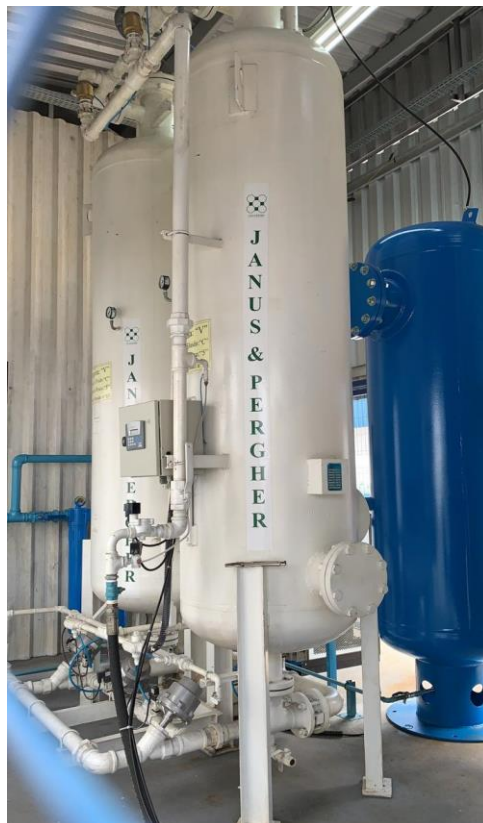
Figura 9- Planta de geração de Nitrogênio PSA JPN- 150.
