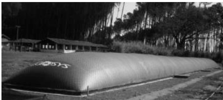
Figura 14 - Biodigestor modelo canadense
