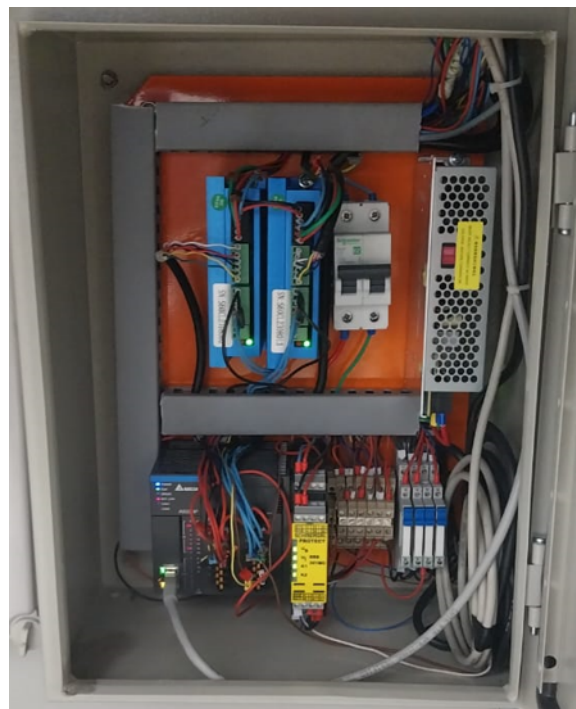
Figura 33 – Painel elétrico finalizado.
