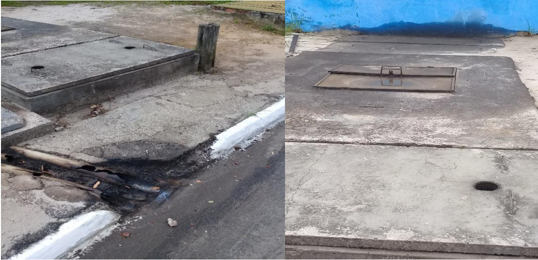
Figura 4 - Partes externa da empresa Amazonas Energia que derrama óleo queimado no solo
