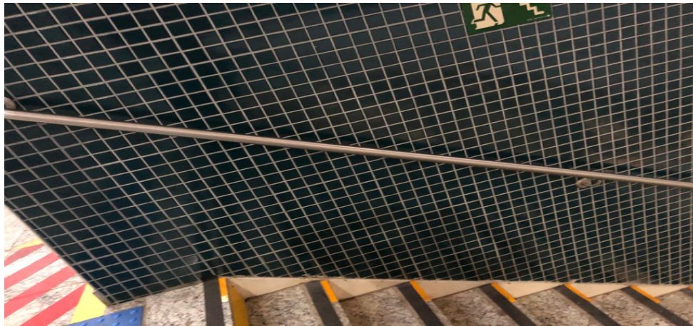
Figura 30 – Barra de aço fixada na parede para apoio em escadas
