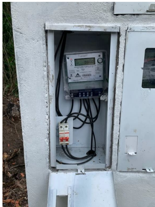
Figura 13 - Medidor que será conectado ao sistema fotovoltaico
