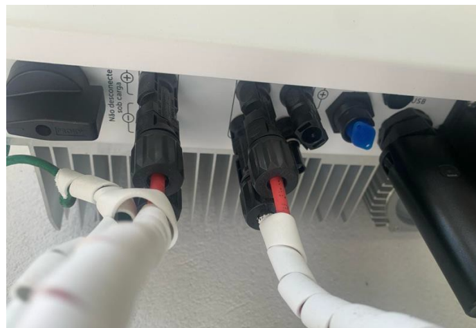
Figura 44 - Conexão de MC4 ao inversor
