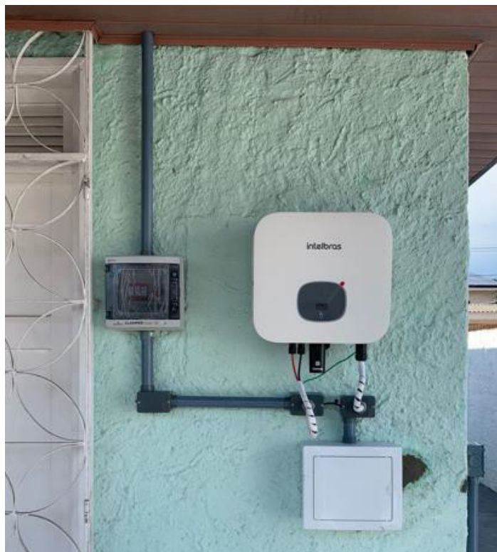
Figura 45 - Inversor e proteções conectados
