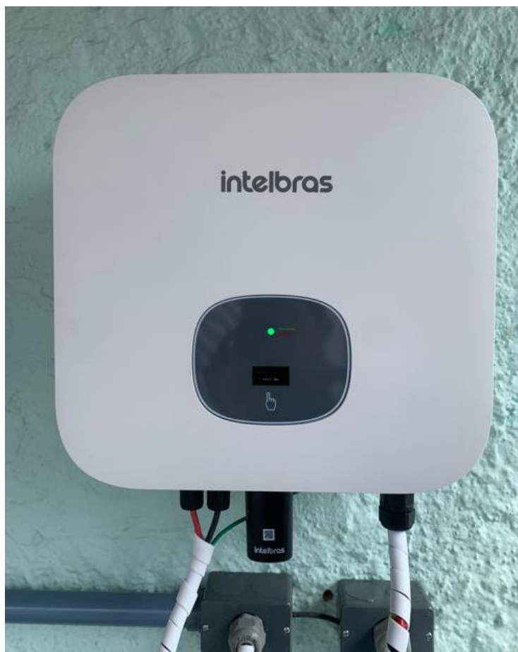
Figura 53- Sistema fotovoltaico ligado
