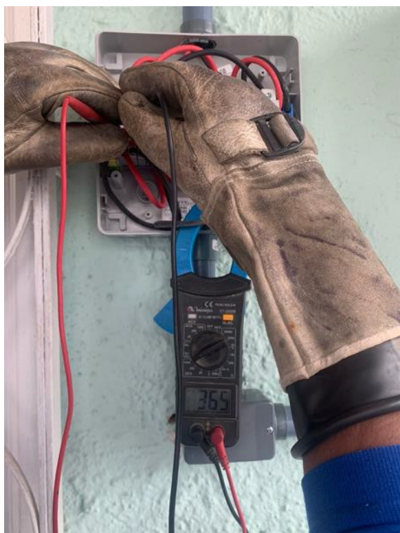
Figura 48 - Medição CC na combiner box
