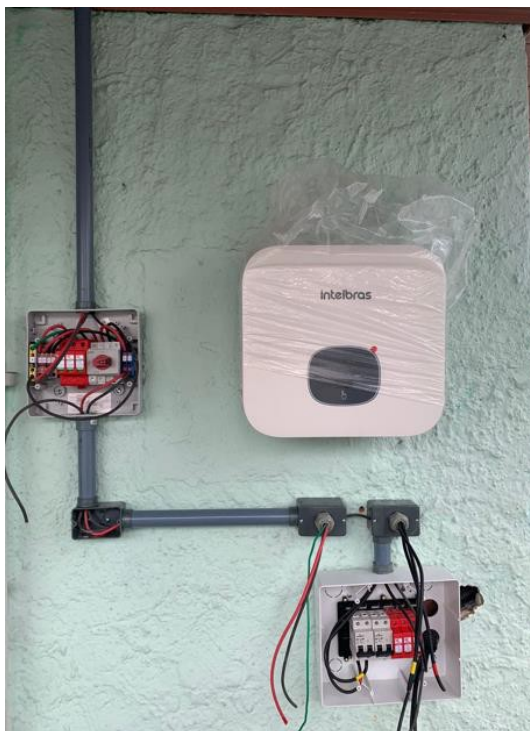
Figura 35 - Inversor e proteções instaladas
