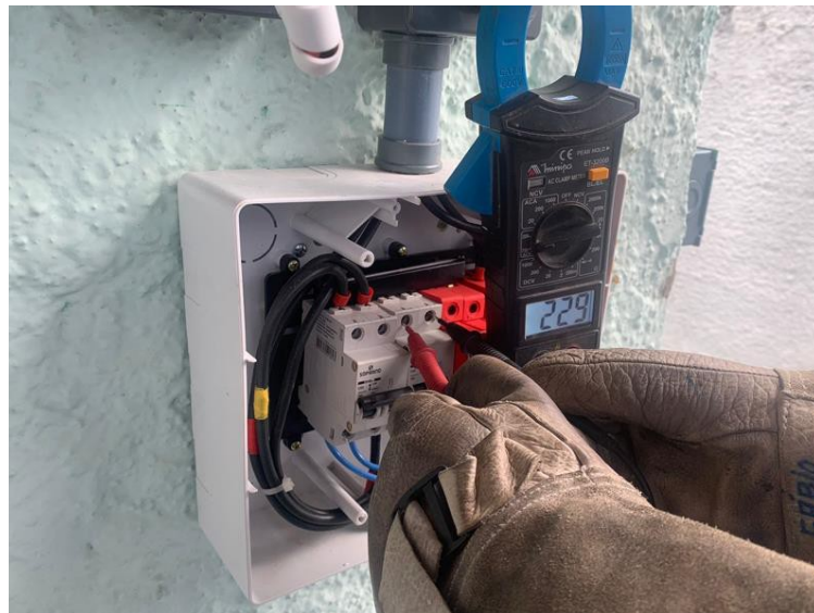
Figura 50 - Medição CA no disjuntor de proteção
