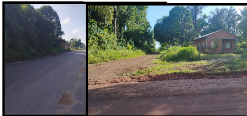
Figura 7: Ramal 1 – Que dá acesso para o Ramal 2 (Lote do Sr. E. B. dos S.)
