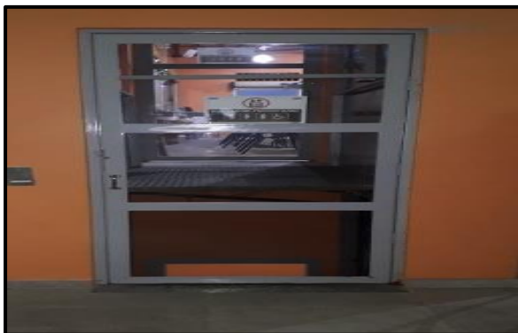
Figura 25 - Porta do elevador
