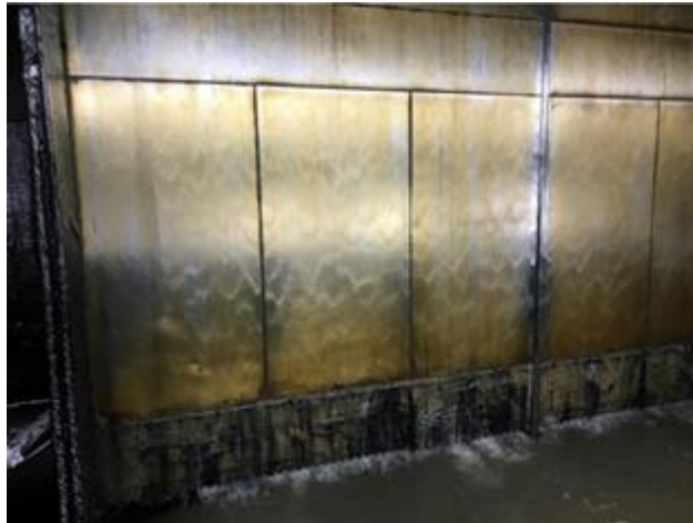
Figura 1 – Cortina de água da cabine de pintura
