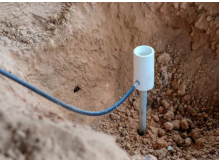
Foto: Soldagem de fio terra de cobre na haste de um aterramento elétrico.
