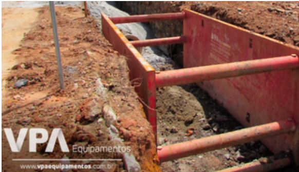
Foto: Exemplo de escavação com paredes em taludes utilizando o método de estacas prancha que são perfis metálicos fabricados em aço de alta resistência com tamanhos e modelos variados. Fonte da imagem: VPA Equipamentos.
