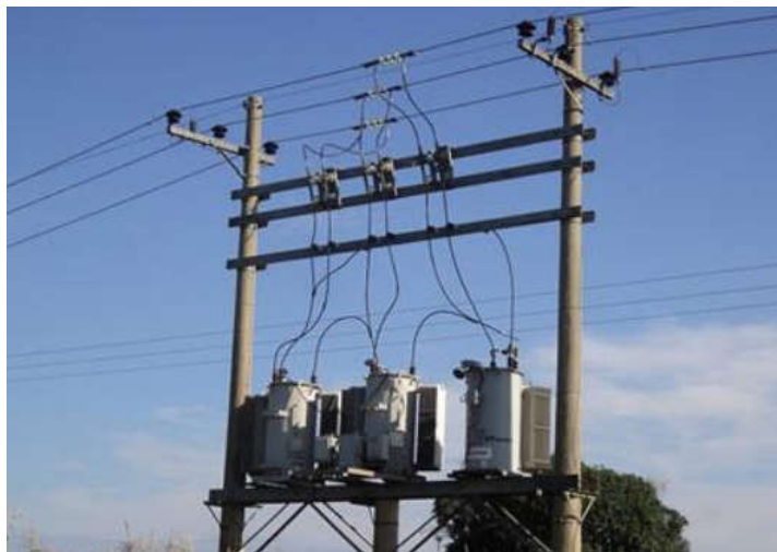
Figura 30- Regulador de Tensão -RT Instalado do PIT 34 L1
