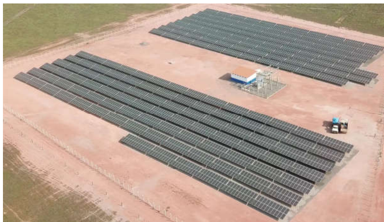
Figura 23- Usina Solar Fotovoltaica de Minigeração de 1625,4 kWp - RICAL
