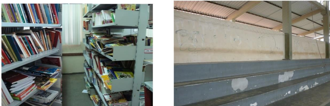
Foto 5 – Biblioteca e quadra da escola sem condições de uso
