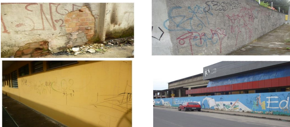
Foto 4 – Muros pichados e quebrados
