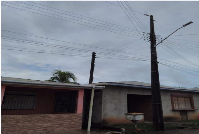
Figura 6. Vista de poste de baixa tensão
