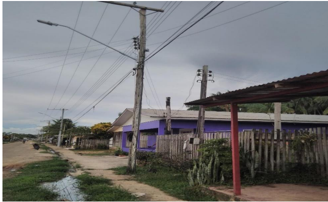
Figura 4. Poste de madeira
