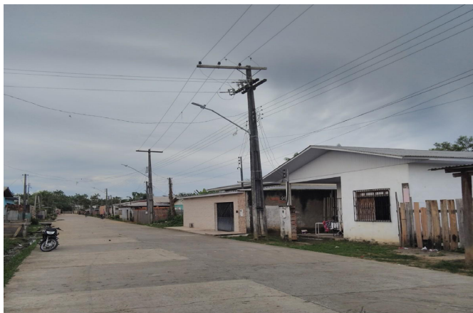
Figura 5. Vista de poste de alta tensão
