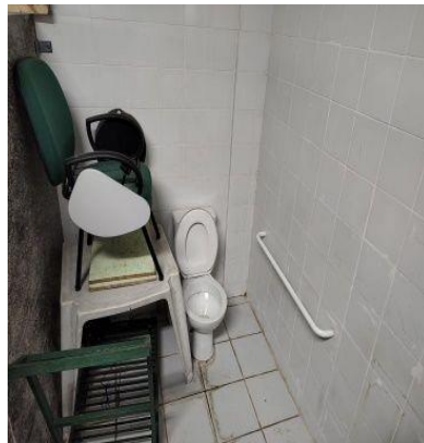
Figura 15 - Banheiro Masculino prédio 1
