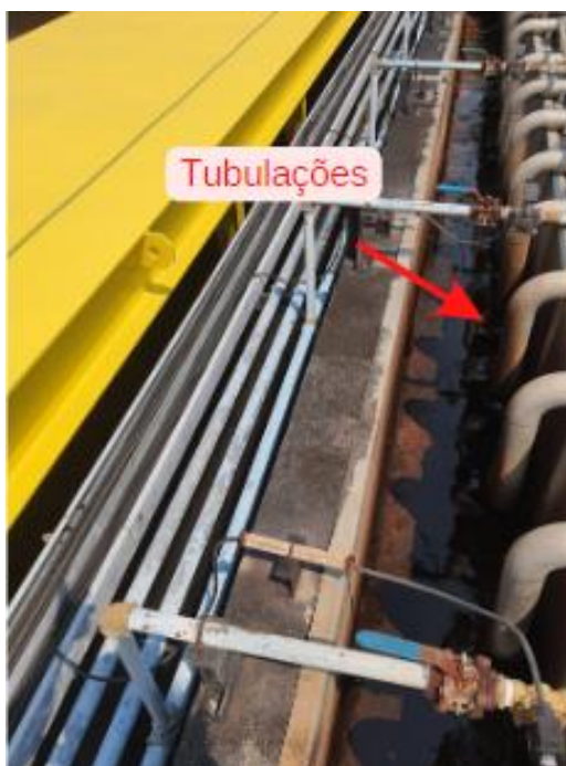
Figura 13- Tubulações de descarga de lodo do decantador 7 da ETA 1.
