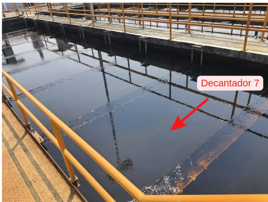
Figura 12- Decantador 7 na ETA 1.
