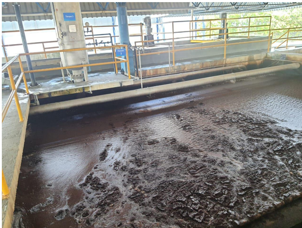
Figura 14- Lodo acumulado no flotador na ETA 2.
