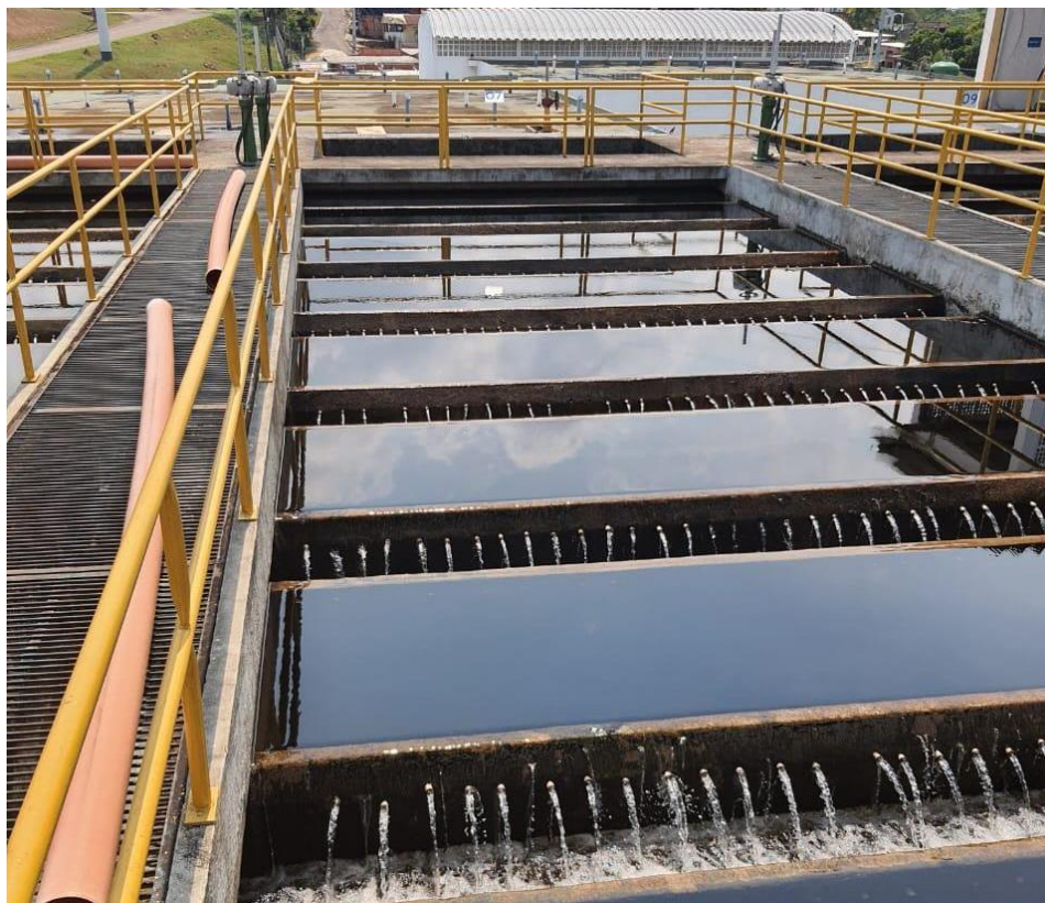
Figura 11- Filtros em uma estação de tratamento de água.
