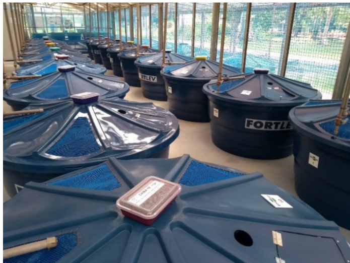
Figura 2 - Vista interna Sistema de caixas d'água de 1.000 L (24 U.E.)
