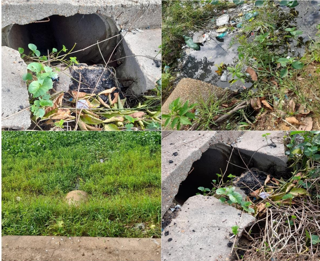
Figura 19: Estruturas de esgotos que despejam resíduos nas águas na Orla da União, Lago Macurany.
