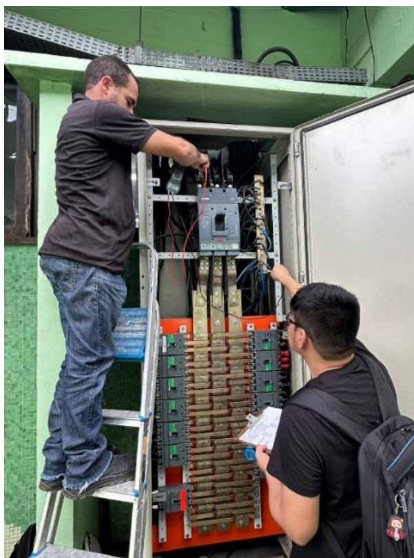
Figura 43 – Medição em quadro elétrico de distribuição.
