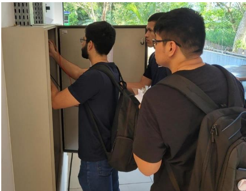
Figura 44 – Medição em quadro elétrico de distribuição.
