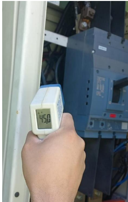
Figura 46 – Medição em quadro elétrico de distribuição.
