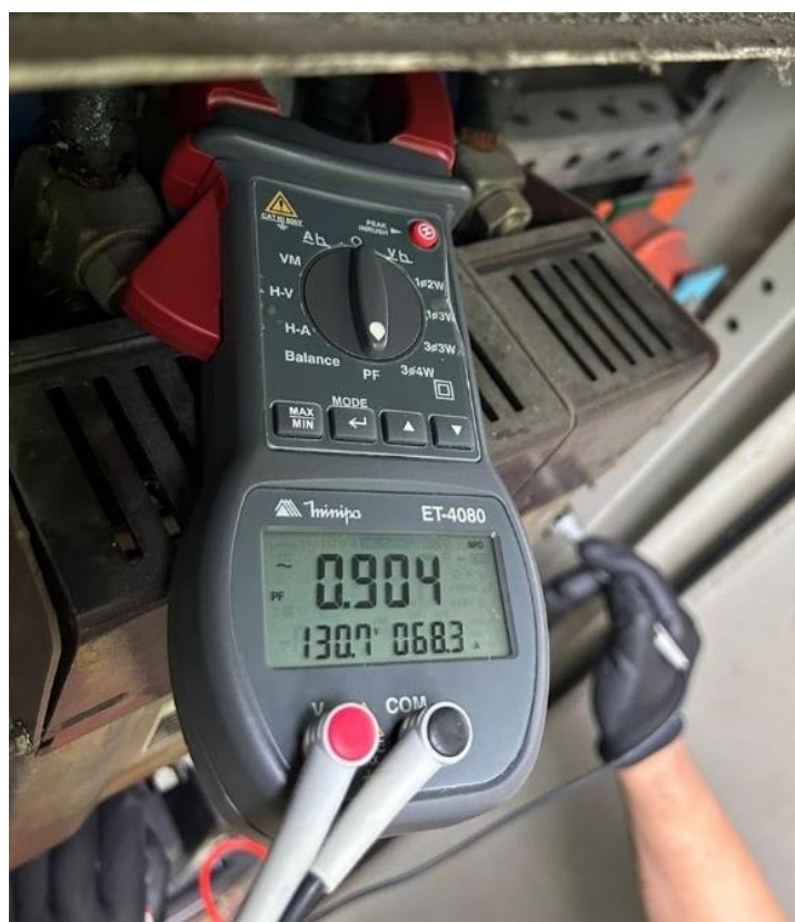
Figura 45 – Medição em quadro elétrico de distribuição.
