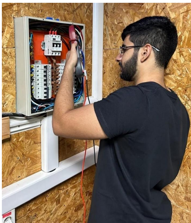
Figura 42 – Medição em quadro de distribuição.
