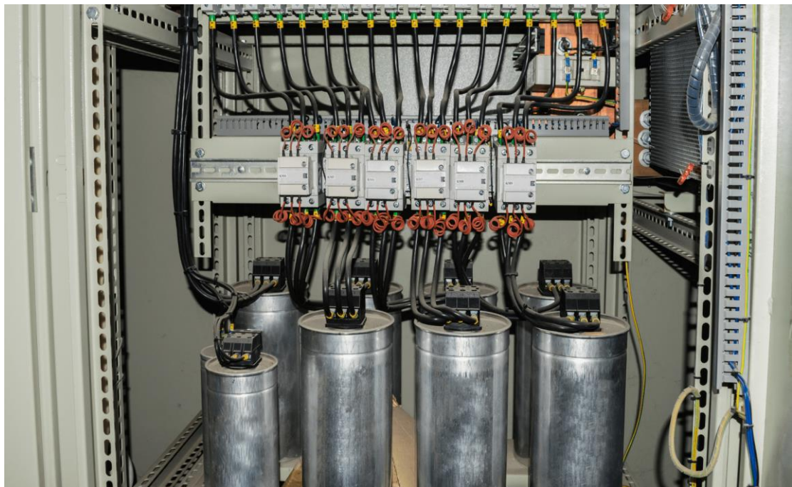
Figura 2-Exemplo de um banco de capacitores em um prédio residencial.
