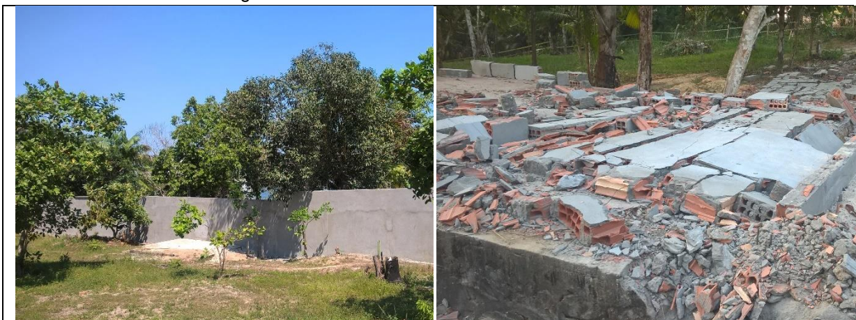
Figura 22- Muro construído em conflito territorial
