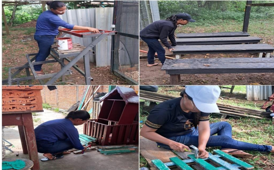
Figura 6 – Processo de reforma das bancadas com reforço de madeira reaproveitada e pintura protetora.
