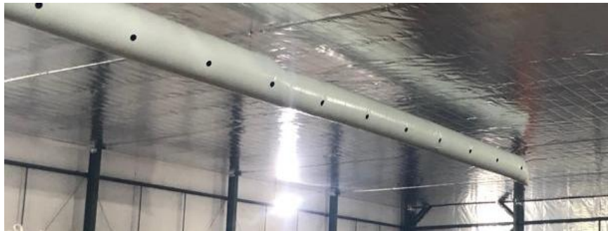
Figura 11 - Sistema de tubulação para distribuição de ar
